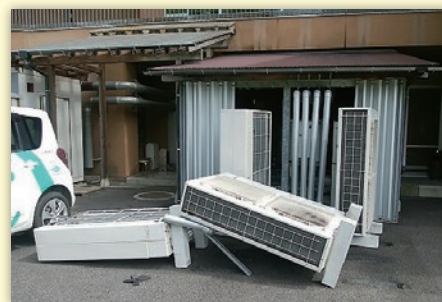
↑暴風により倒された市原園の「エアコン室外機」。
